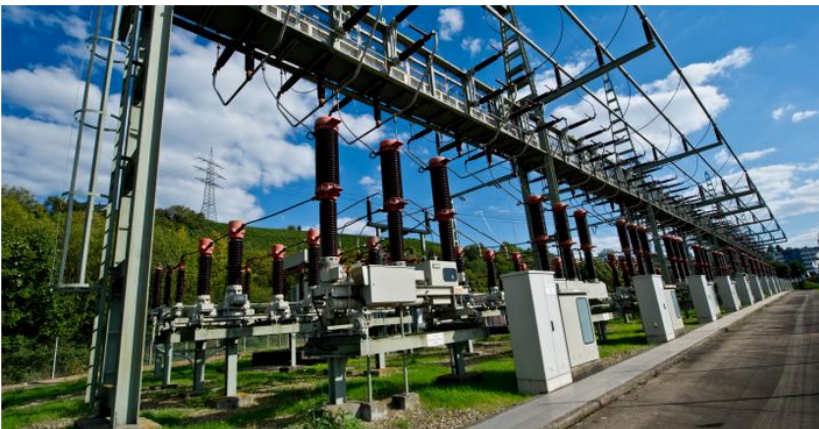
EnBW erweitert seine Dienstleistung zu IT-Sicherheit auf Betriebsmittel wie beispielsweise Umspannwerke. (Foto: Lichtgut/Volker Hoschek/SW Stuttgart)
